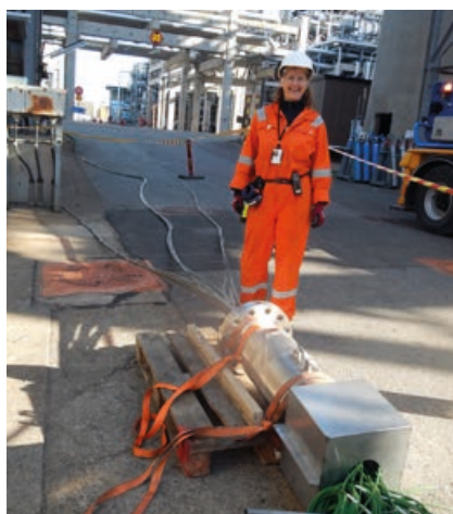
Rita Refvik, Endress+Hauser, står ved Octoplus Multipoint, der er ved at blive klargjort til installation.
