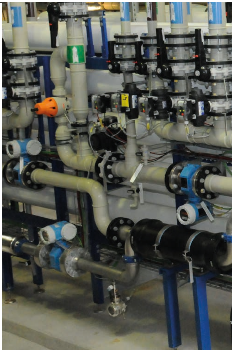
Amagerværket har et avanceret vandrensningsanlæg, som står for afsaltning af det vand, som anvendes på kraftværket. Vandet er havvand, som kommer direkte fra Øresund. Anlæggets måleudstyr er leveret af Endress+Hauser.
