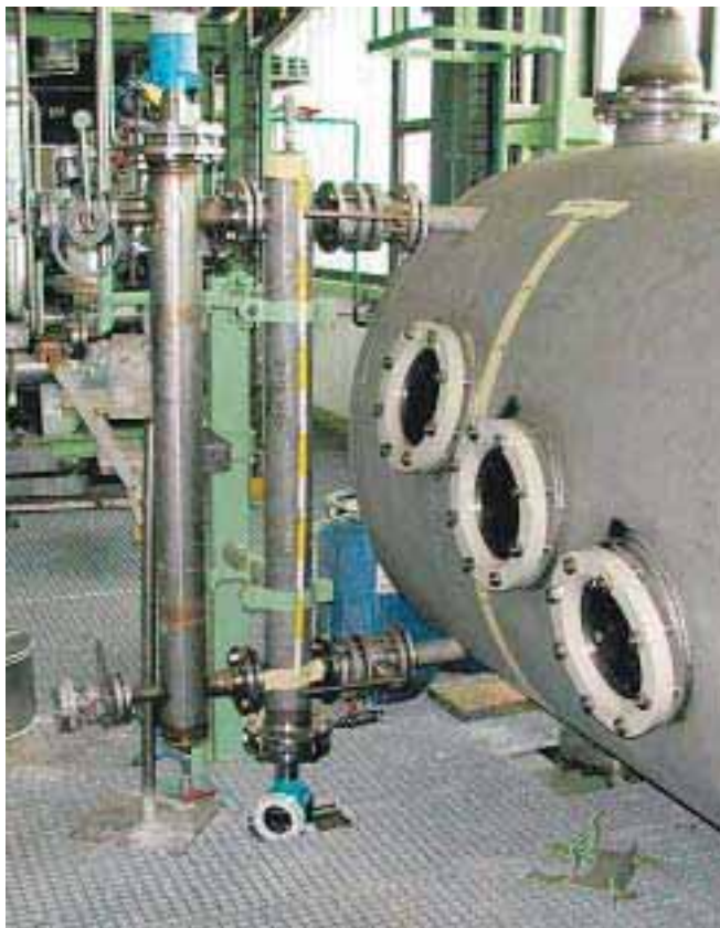
Fig. 6. En guided radar niveaumåler monteret op/ned (nederst i midten) benyttes til at måle grænsen mellem vand (øverste lag) og det tungere dimethylenklorid. Øverst til venstre ses en kapacitiv niveaumåler til bestemmelse af niveauet i tanken.
