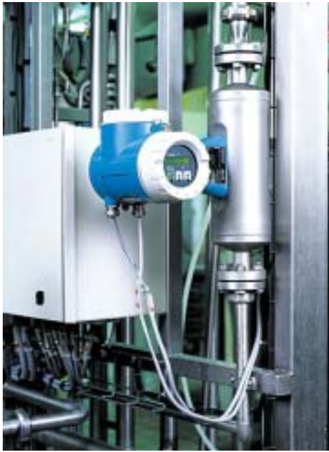
▲ - Benyttes PROMASS I måleren til bestemmelse af tørstofindholdet i en kalkopslemning anbefales lodret montage - så partiklerne ikke bundfældes i måleren.
