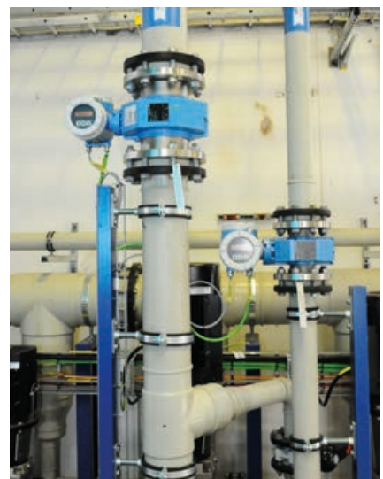
Over alt på afsaltningsanlægget på Amagerværket sidder målere fra Endress+Hauser, som sørger for at overvåge alle de kritiske parametre for vandkvaliteten, heriblandt tryk, temperatur, flow, niveau, pH-værdi og ledningsevne.
