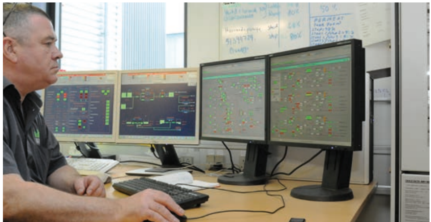
Måleudstyret fra Endress+Hauser gør det muligt at drive et effektivt, sikkert, miljøvenligt og energioptimeret afsaltningsanlæg, der er fuldt integreret med Amagerværkets overordnede SRO-system Siemens T3000, fortæller driftsmedarbejder John Martinussen.
