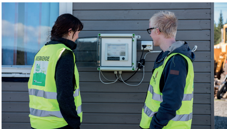
WirelessHART sender trådløs information fra kompostområdet til den centrale enhed (RSG45) placeret udenfor kontorbygningen, hvor operatøren nemt kan læse temperaturen.
