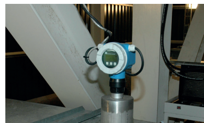
I et anlæg af Valsneset's størrelse udføres et stort antal procesmålinger, blandt andet måling af niveau i forskellige siloer, lagerbeholdere og processtanke. Billedet viser en ultralyds niveaumåling med Prosonic FMU41 fra Endress+Hauser.
