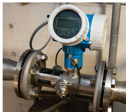
I kælderen under rådnetårnet er flowmåleren i gang med at måle på metanflow og metanindhold.
