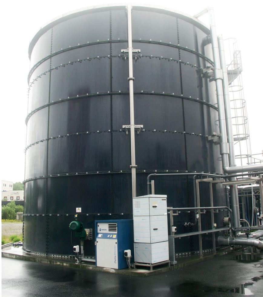
Det filtrerede vand opsamles i en 600 m 3 lagertank.
