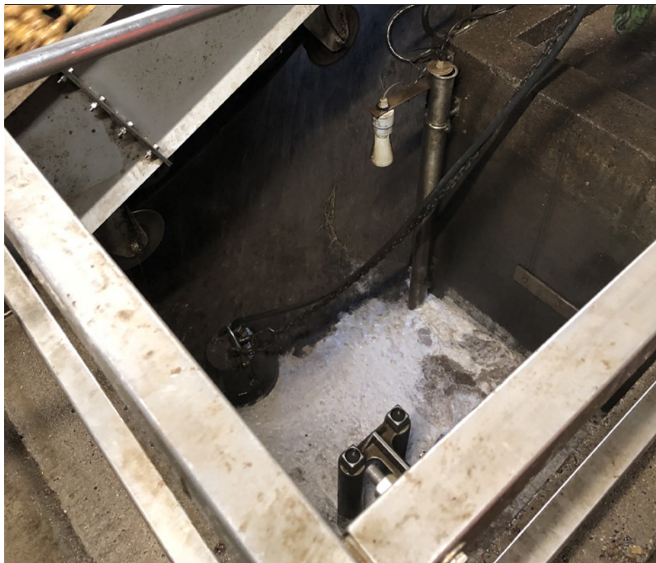
For at minimere forbruget af vand, overvåges renseprocessen nøje. Her anvendes en FMR10 freespace radar fra Endress+Hauser til niveauovervågning.
