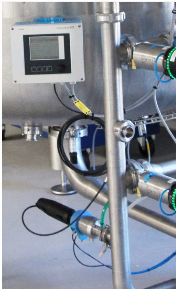
pH installationen med CM442 øverst og CPA875 med pneumatisk udtræk for automatisk rengøring nederst på billedet.
