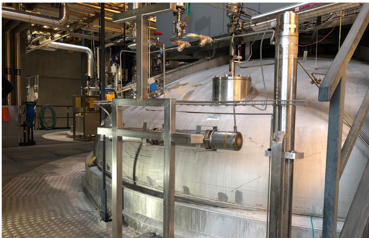
På den eksisterende detektorinstallation ses de små rørføringer, som tilfører køling.
