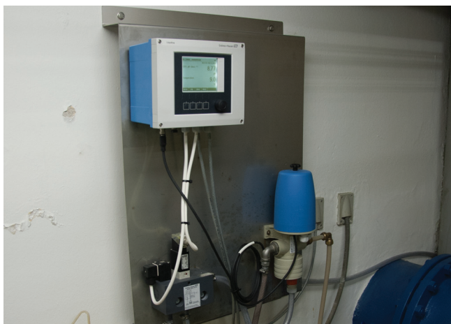
Anlægget som det ser ud ved indløbet fra boringerne på vandværket i Varde. Her måles pH-værdien og sendes via Liquiline transmitteren til kontrolrummet.
