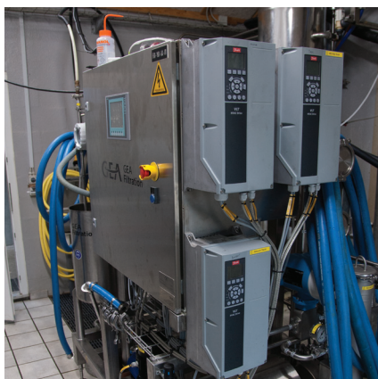
Opkoncentreringsanlægget til reduktion af vandindholdet i mælk er konstrueret i et nært samarbejde mellem Arla Foods, GEA Filtrations, DKC, AU Foulum med støtte fra Miljøministeriet og Endress+Hauser.
