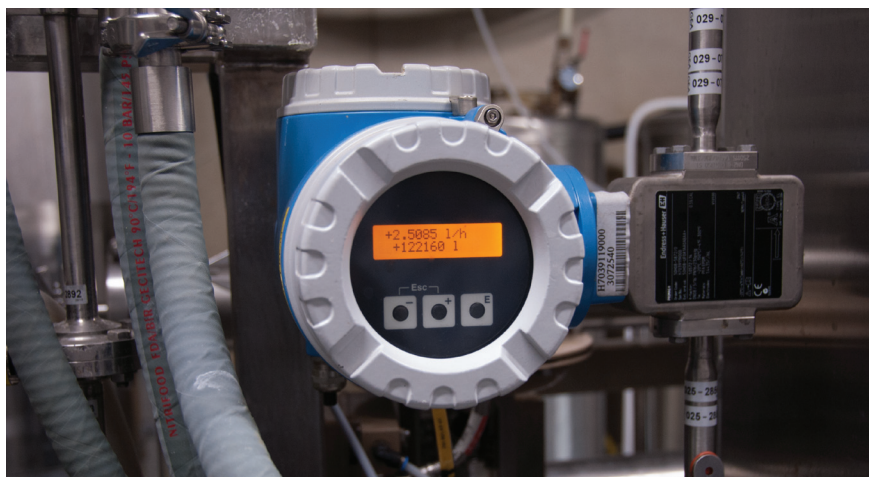
En af de to 2 Promag 50H flowmålere, der er leveret af Endress+Hauser til opkoncentreringsanlægget i Foulum ved Viborg.
